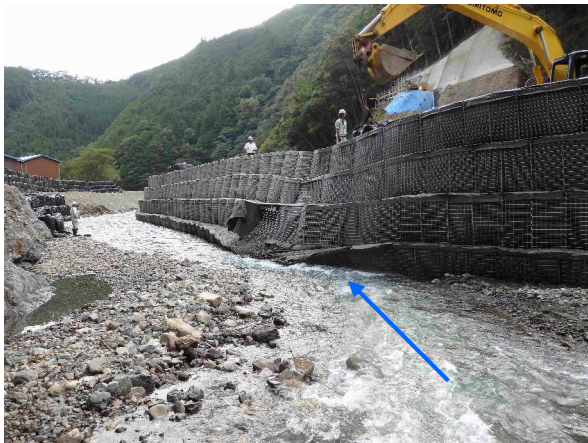
図-15 連続箱型鋼製枠の破損および変形
