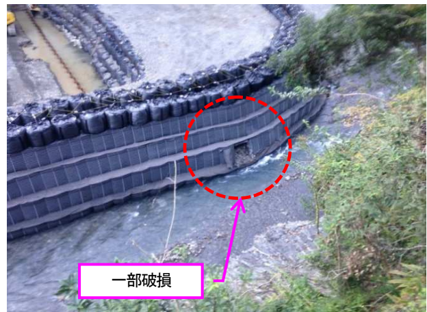
図-14 台風16号による破損
