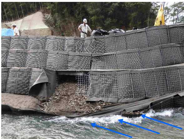
図-16 連続箱型鋼製枠パネル破損部
