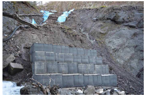
図-4 抑止工（コンクリート擁壁）の残存型枠
