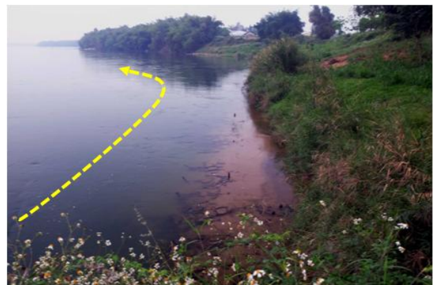
写真-6 河岸前面の土砂堆積 (2016)
