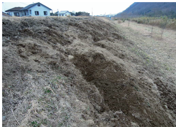
写真-1 堤防法面の掘り返し(2015/1/21桐生川にて撮影)。
