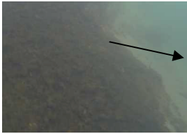
図-16 深掘れ孔上流端部 付近の水中写真
