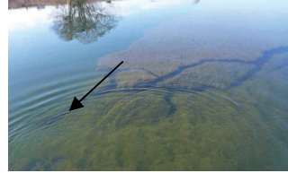
図-17 深掘れ孔の側岸端部 の洗掘状況
