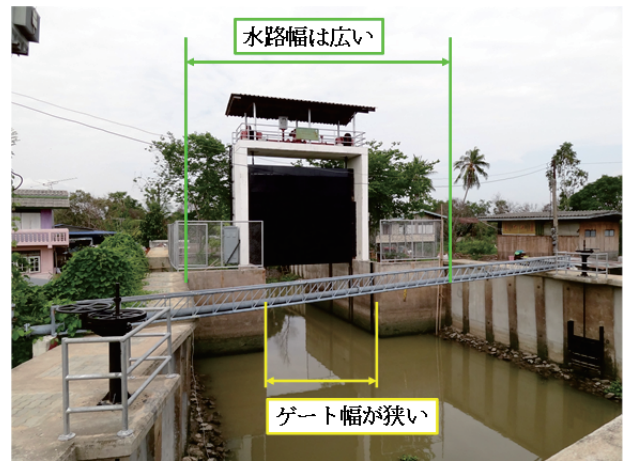
図-2 農業用水路に設置されたゲート
