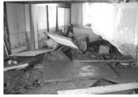
図-4 床上まで堆積した土砂
