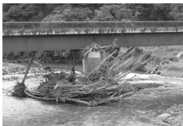
写真-4 玉来新橋の橋脚に集積した流木
