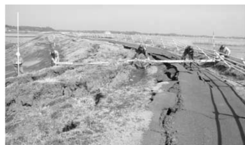
写真-2 湊沼川・下石崎の被災状況 (関東地方整備局提供)
