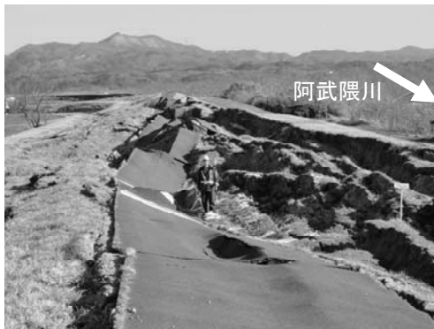
写真-1 阿武隈川・枝野の被災状況
