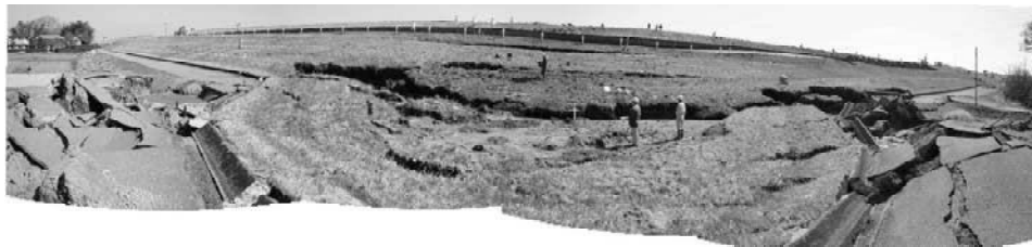
写真-3 江戸川・西関宿の被災状況 (関東地方整備局提供)
