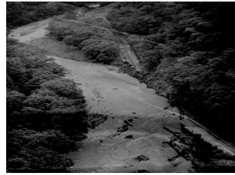
図-2 忠別川上流部における道路崩壊
