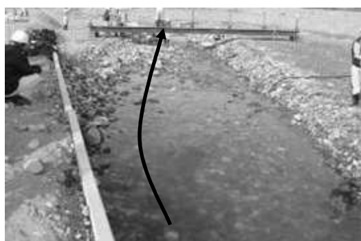
写真-10 水衝部②1 回目通水後護岸前面の盛土砂州の消失
