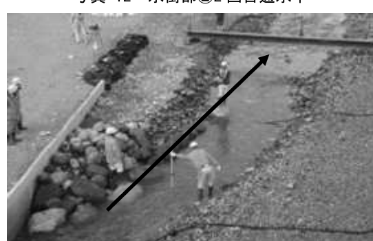
写真-13 水衝部②2 回目通水後 変化無し
