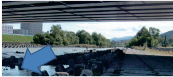
写真-5 低水路内に侵入している樹木（被災箇所直上流）
