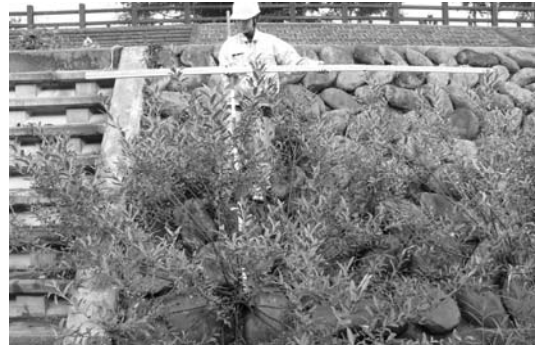
写真-9 2年目の状況 (2010. 11. 11 撮影)
