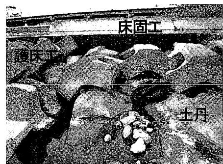
写真-4 元横山床固下流の土丹露出状況
