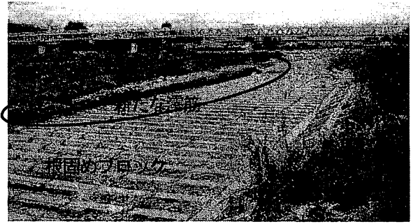
写真-3 10.0k 付近の根固めブロック前の洗掘状況
