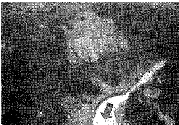
写真-3 塚原ダム下流側の山腹崩壊箇所（宮崎県日向土木事務所提供）
