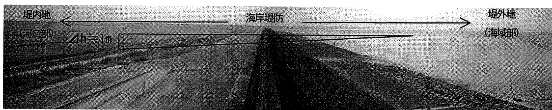
写真-1 六角川河口部の海岸堤防における堤内外のガタ土堆積状況 (平成 15 年 8 月撮影)
