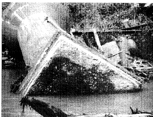
写真-6 第3鉄橋の橋脚の倒壊状況
