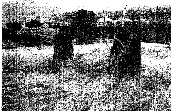
写真-7 第4鉄橋の橋脚の倒壊状況
