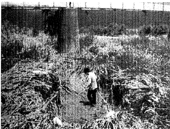
写真-8 第4鉄橋の橋脚下流の洗掘孔の状況
