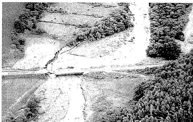
写真－5 栄進橋の被災状況 (シン技術コンサル提供)
