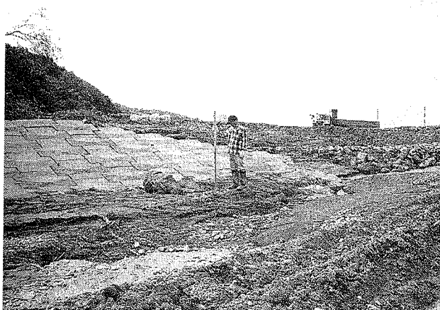
写真-4 厚別川下流C地点における護岸の被災状況
