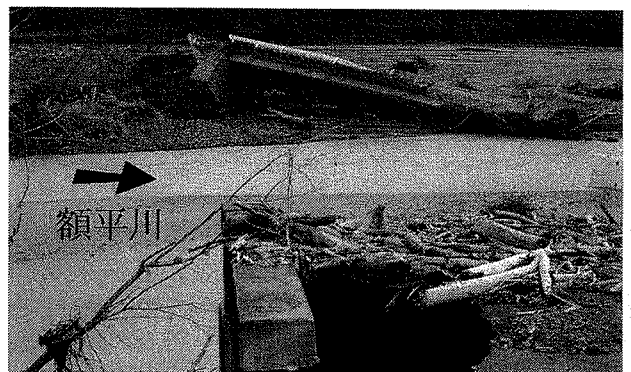
図-2 幌見橋の被害状況
