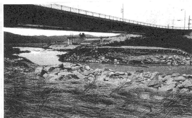
写真-1 決壊した二の荒手堰堤 (1998 年 10 月)
