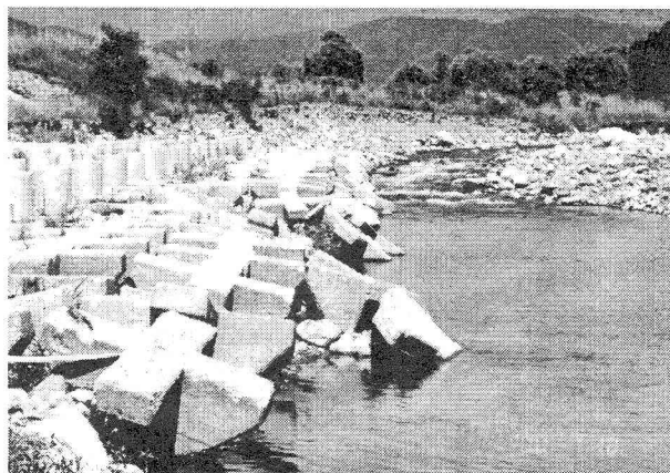
写真-1 河床低下 (右岸 4Km 地点)
