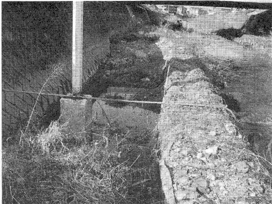
写真-3 香流川低水路部の蛇籠背面土砂流出状況
