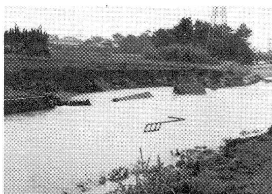
写真-1 柳枝工上流部のコンクリートブロック被害状況（逢妻女川）
