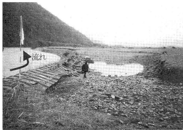
写真-1 高水敷の洗掘状況
