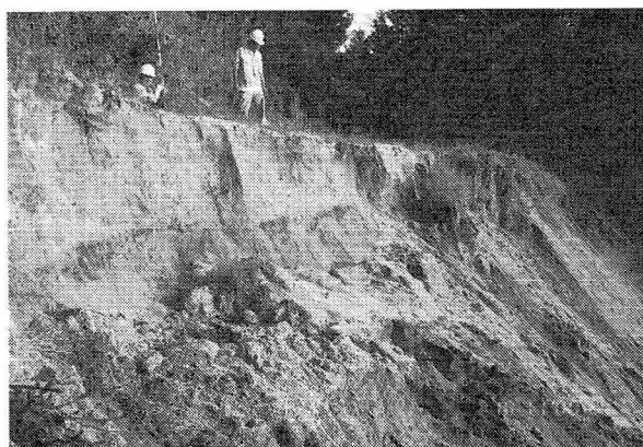
写真一3 上矢作町阿寺の斜面崩壊最上部
