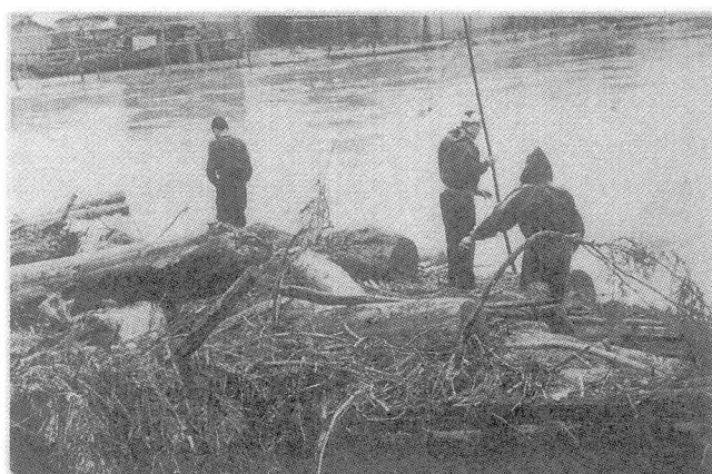
写真-8 上大畑橋湯坂下側より橋脚に堆積した流木の状況
