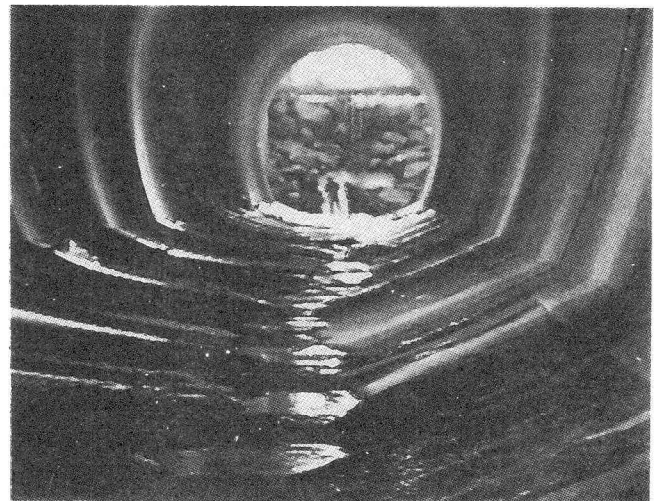
写真-1 インバート部の侵食状況 (温井ダム)
