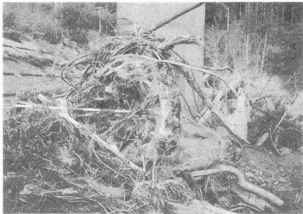
写真-5 大畑川 4.6km に架かる小目名橋の橋脚への流木の引っかかり状況
