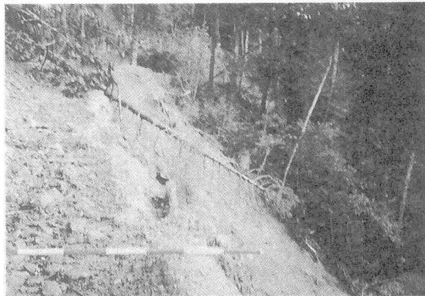
写真-9 作業道最上流部における崩落状況
