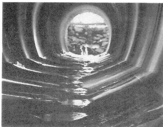
写真-1 仮排水路トンネルインバートの浸食蛇行
