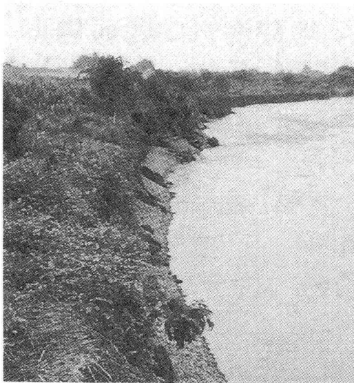
写真-1 調査地点の河岸の侵食状況
