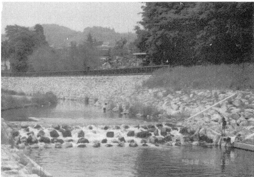
写真－2 多段式落差工の全景
