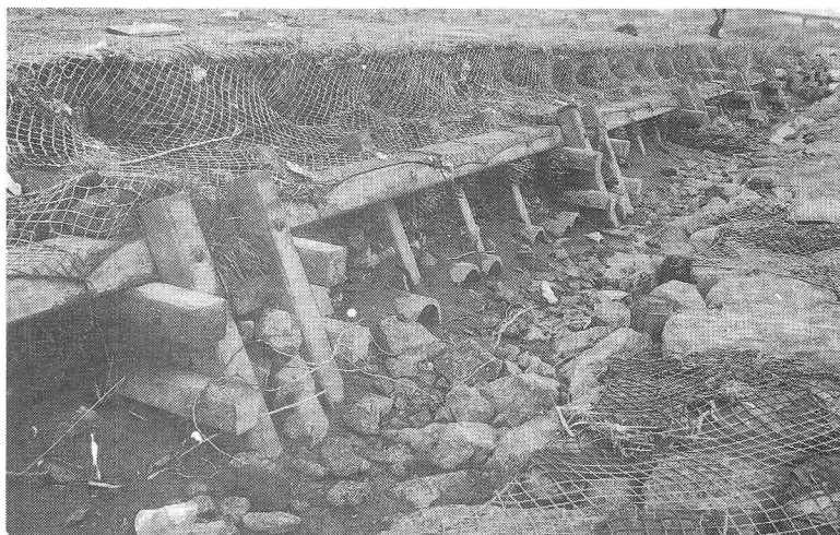
写真-1 平成3年度施工箇所（平成5年の出水後の状況）
