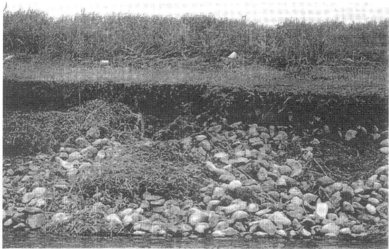
写真-1 被災状況
