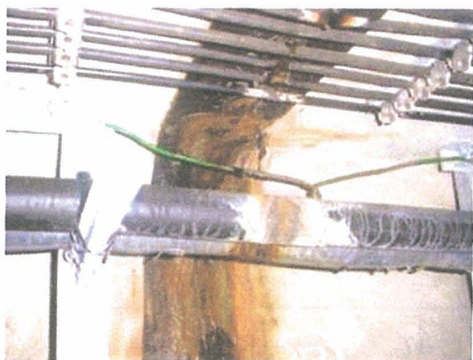
写真-3 施工前の漏水状況
