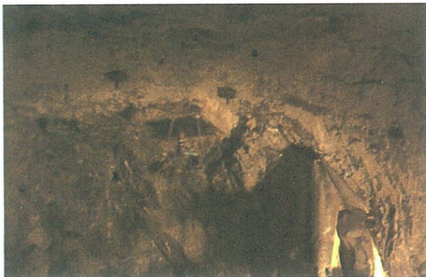
(c) 翌朝、リークが再び発生した状況
