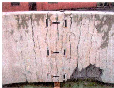
写真-2 従来型ひび割れ発生状況
