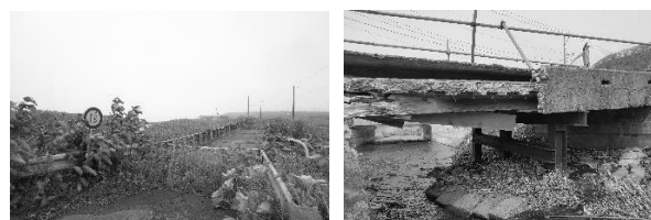
写真-2 左) 通行が禁止されている（初山別村 歌越別橋） 右) 桁や橋脚が損壊している（積丹町 柏谷橋）
