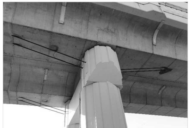
図-9 浮塚高架橋 SU ダンパー [11]
