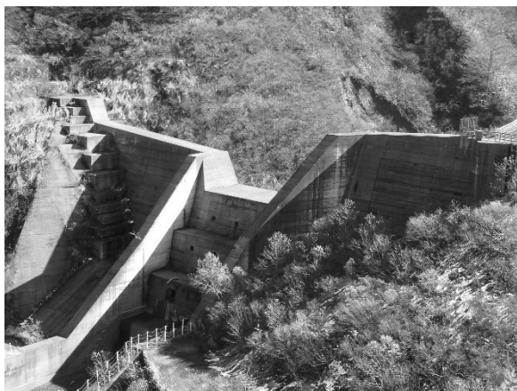
写真-11 火打山川第1号砂防ダム現況写真 （撮影日：2020年11月15日）
