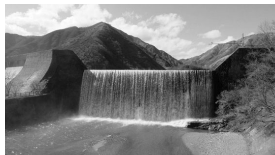
写真-1 足尾砂防堰堤 現況写真（越流堤部） （撮影日：2020（令和2）年3月11日）
