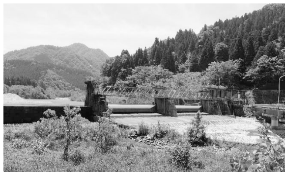
図-7 蓑輪頭首工：エプロン部の摩耗対策のための鉄板敷きが特徴的
