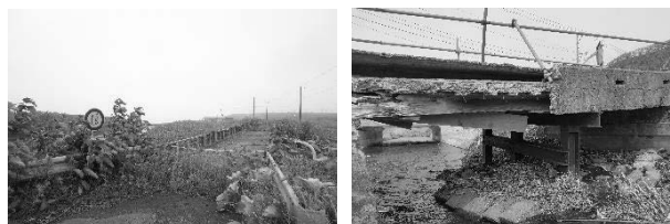
写真-2 左) 通行が禁止されている（初山別村 歌越別橋） 右) 桁や橋脚が損壊している（積丹町 柏谷橋）
