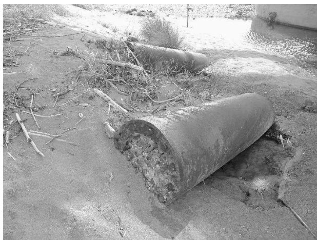
図-12 現在の長良川橋梁のふもとに残る鑄鉄管橋脚の一部 (2016 年に筆者撮影)
