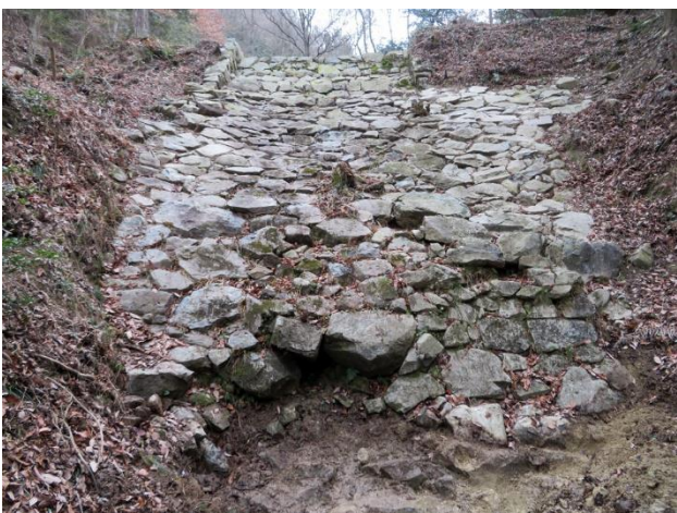
写真-10 下部が大きく抜け落ちていた十一番砂留
