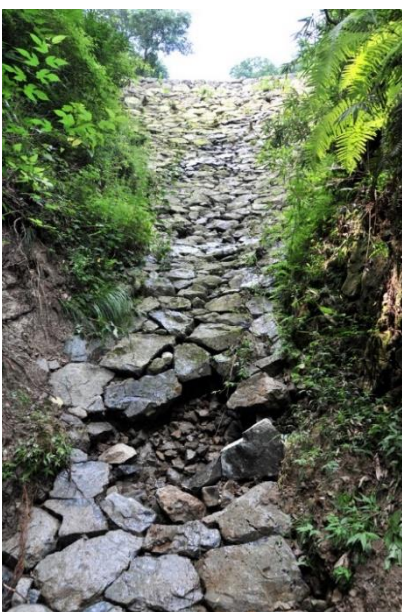
写真-6 石材が流出した九番砂留
