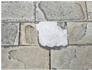
写真 5.4 モルタルで修復され、一部破損している
