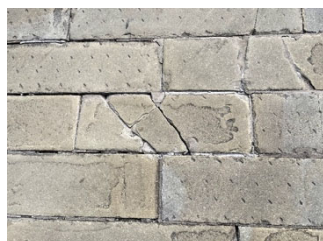
写真 5.3 割れている状態
