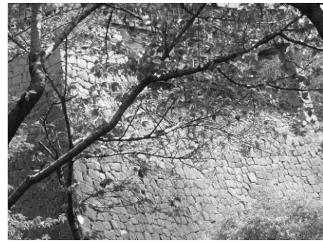
写真-3 2016年熊本地震後の飯田丸五階櫓台石垣南面と西面
