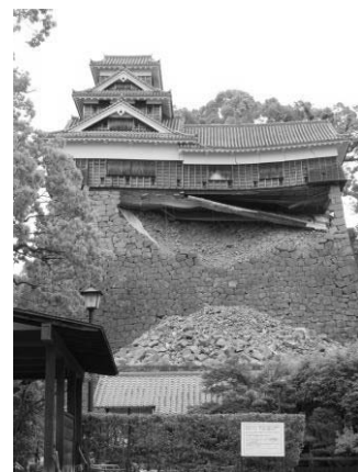
写真-2 2016年熊本地震本震後の飯田丸五階櫓台南面
