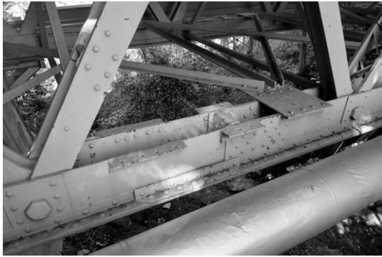
写真 - 5 大宮橋左岸上流側格点 1～2間の下弦材
