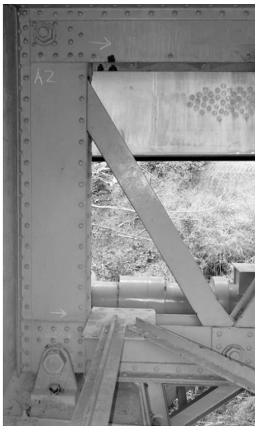
写真 - 9 大宮橋左岸下流側端柱内側
