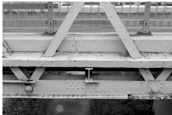
写真 - 8 浜中津橋右岸上流側格点 1～2間の下弦材
