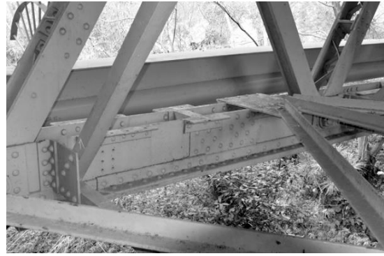
写真 - 6 大宮橋左岸下流側格点 1～2間の下弦材
