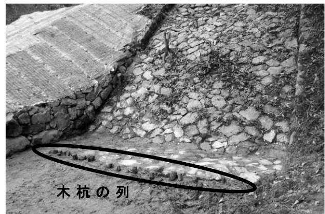
写真-1 五番砂留左岸側の水通し下端部の木杭
