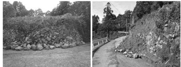
図-6 上部から破壊した空石積み擁壁の様子
