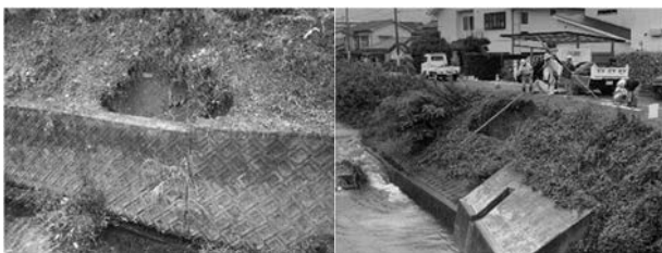
図-23 背後のみが破壊しているコンクリート護岸の様子
