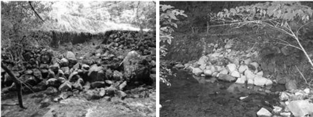
図-9 上部から破壊された空石積み擁壁の様子
