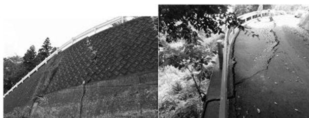
図-16 コンクリート擁壁の破壊の様子
