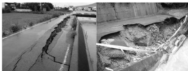
図-18 コンクリート護岸の破壊の様子
