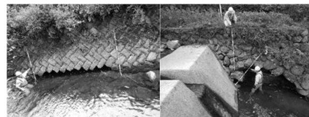
図-21 練石積み護岸の破壊の様子
