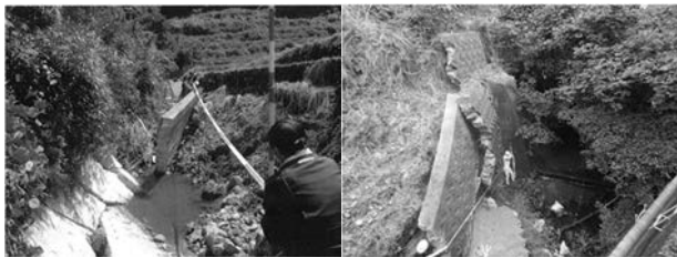
図-19 コンクリート護岸の破壊後の躯体片の様子
