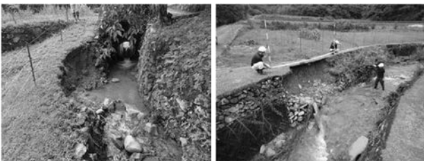
図-10 崩れた石材が流失している様子
