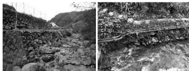
図-20 空石積み護岸の破壊の様子
