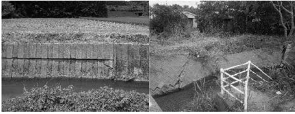
図-22 コンクリート護岸の破壊の様子
