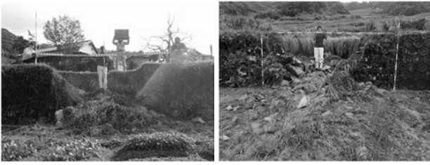
図-7 空石積み擁壁の上に乗っている様子
