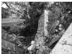
図-14 躯体が一体となって滑落している様子
