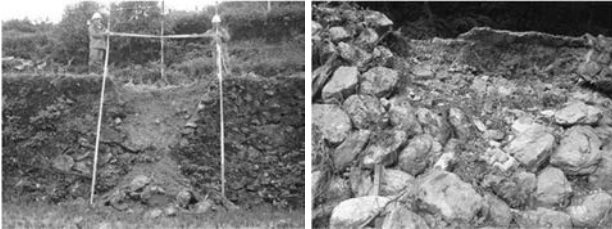
図-8 崩れた箇所が下に行くほどずぼまっている様子
