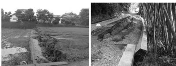
図-17 躯体が転倒している様子
