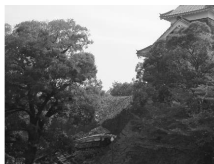
写真-4 2016年熊本地震後 未申櫓台石垣北側（C, Dエリア）
