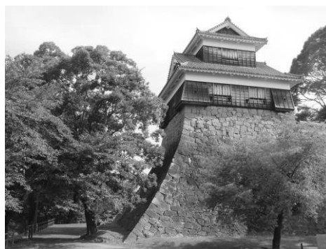
写真-3 2016年熊本地震後 未申櫓台南西隅（E, Fエリア）
