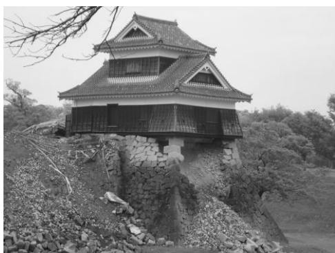
写真-2 2016年熊本地震本震直後 戊亥櫓
