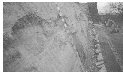
図-20 Cエリア崖錐整形状況 1)
