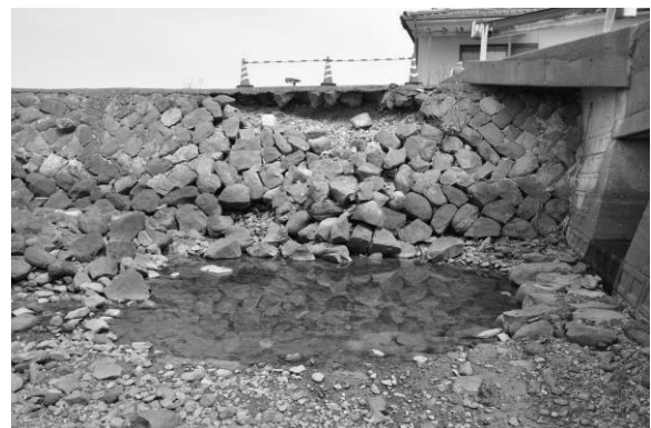
写真-5 崩落部の様子（撮影：本田、2016. 12. 18）
