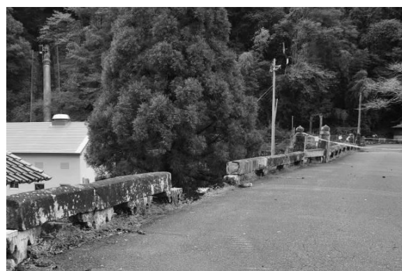
写真-8 高欄落下箇所（撮影：本田、2016. 09. 20）
