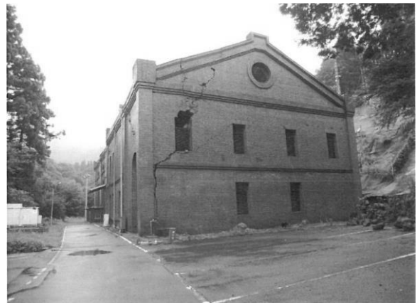
写真-15 被災後南側壁面 (JNC(株)提供)
