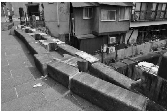
写真-1 倒壊した高欄（撮影：本田、2016. 05. 25）
