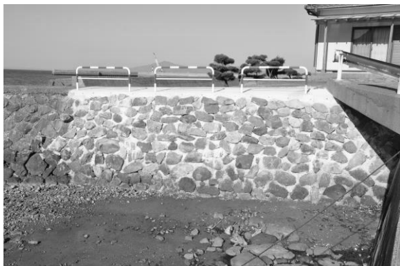
写真-6 修復部全景（撮影：本田、2017. 2. 17）
