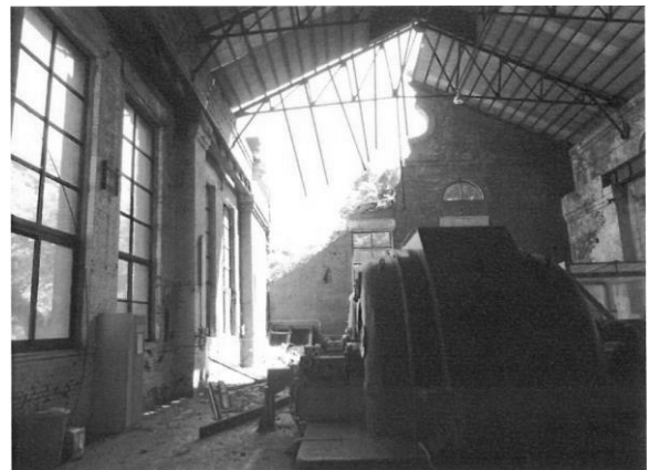
写真-16 被災後北側壁面 (JNC(株)提供)
