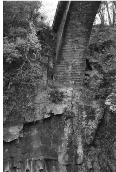
写真-24 岩盤崩落部の状況 (撮影:本田、2016. 11. 29)
