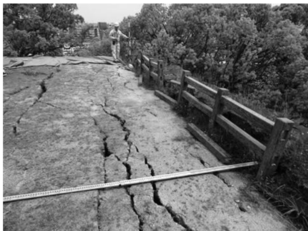
写真-2 長局櫓前のクラック発生状況
