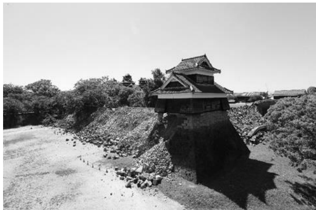
写真-1 戌亥櫓の石垣崩壊状況
