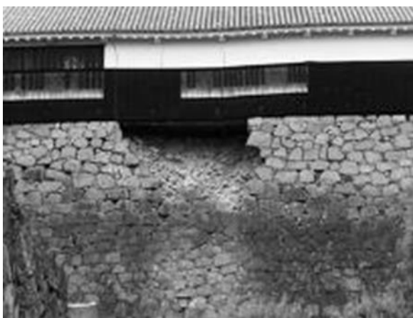
写真-5 H323 の被災後の様子
