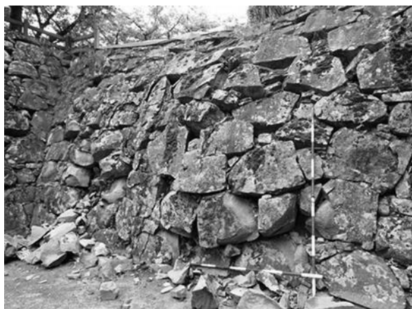
写真-3 本丸東門横石垣の孕み出し状況
