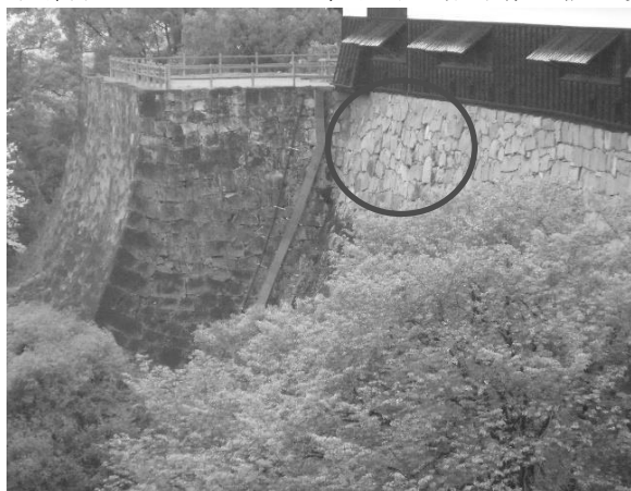
写真-4 H323 の被災前の様子
